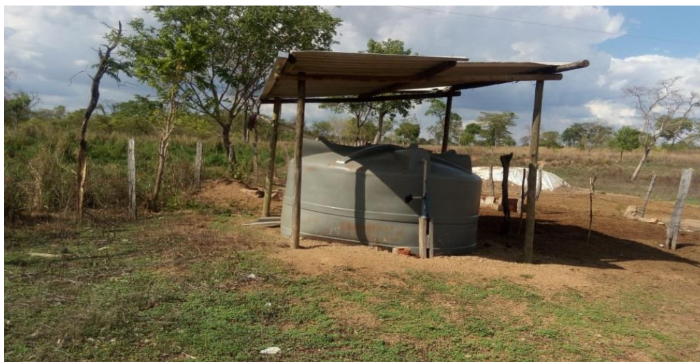
Figura 8 - Cisterna em funcionamento em Aurora do Tocantins, 2018
