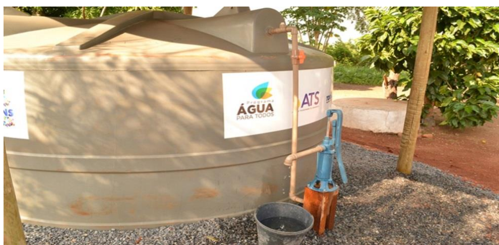
Figura 6 - cisterna rural com bomba – Aurora do Tocantins, 2018.
