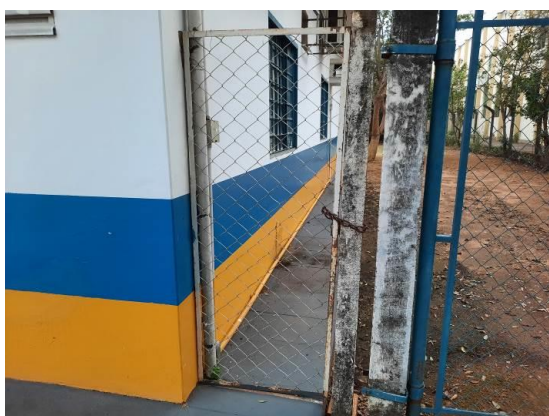
Foto 11 – PORTÃO METÁLICO IMPROVISADO - TELA
