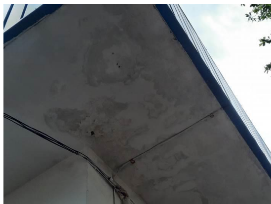
Foto 10 – INFILTRAÇÕES NA LAJE DE COBERTURA – DECORRENTE GOTEIRAS NO TELHADO
