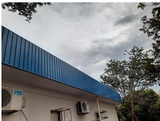
Foto 7 – VISTA DA PLATIBANDA METÁLICA NECESSÁRIO NOVA PINTURA
