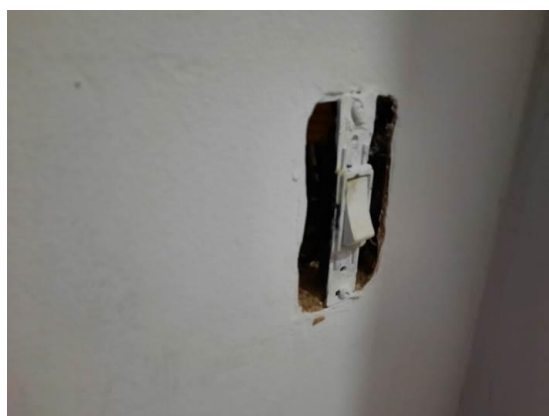
Foto 18 – INTERRUPTOR FALTANDO ESPELHO
