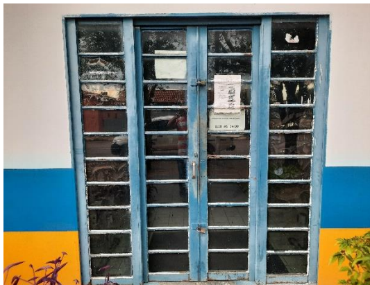
Foto 5 – PORTA METÁLICA - NECESSÁRIO NOVA PINTURA
