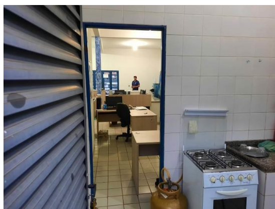
Foto 12 – FALTA PORTA NA COZINHA
