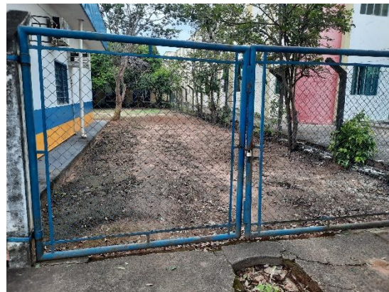
Foto 6 – PORTÃO DA GARAGEM – NECESSÁRIO NOVA PINTURA
