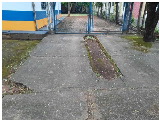
Foto 8 – PASSEIO EM CONCRETO COM TRINCAS E PARTE DETERIORANDO
