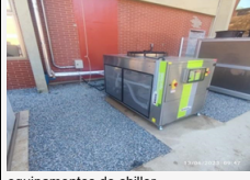
Central de Máquinas de Chillers abrigo dos equipamentos de chiller
