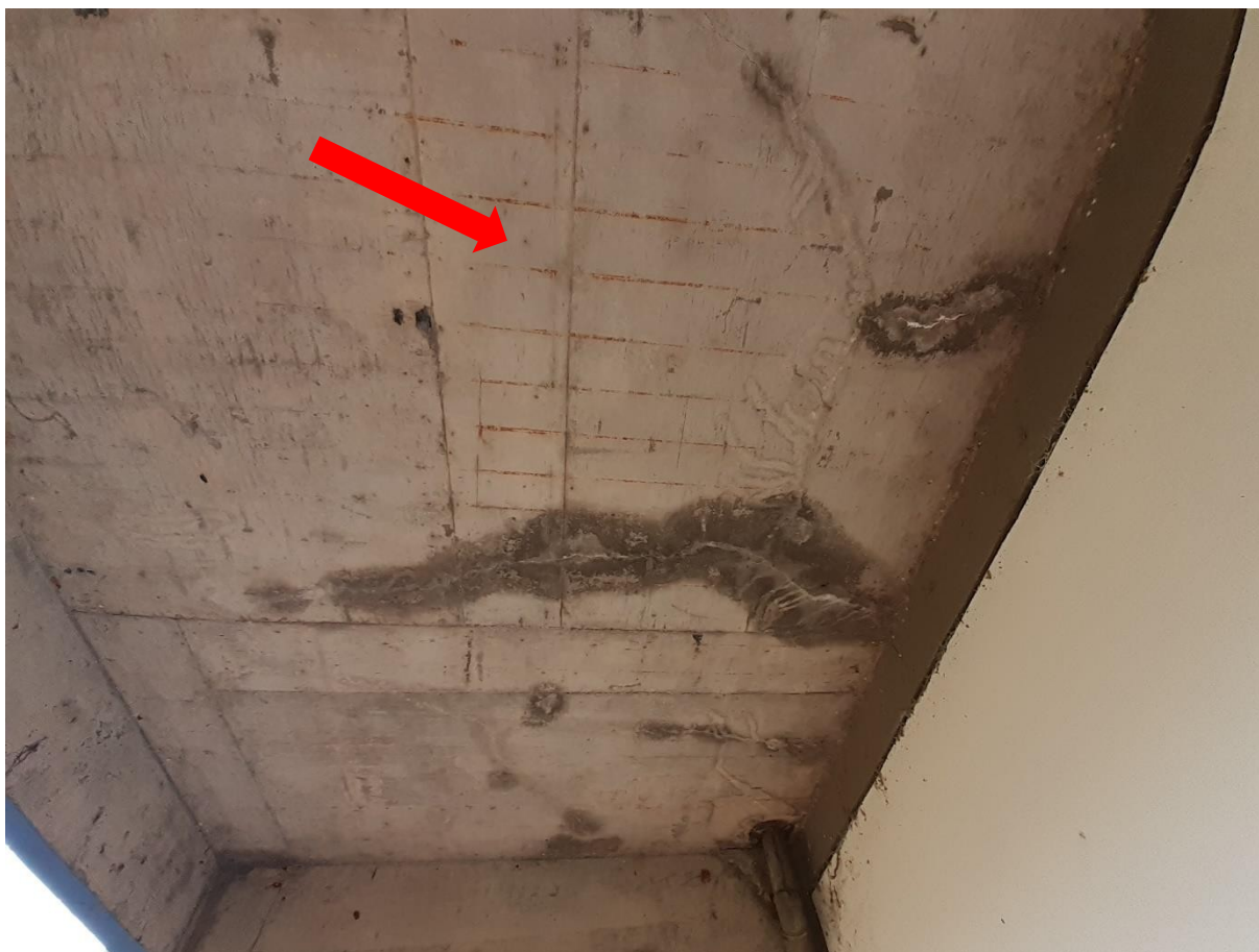
Foto 159: Infiltração em marquise
