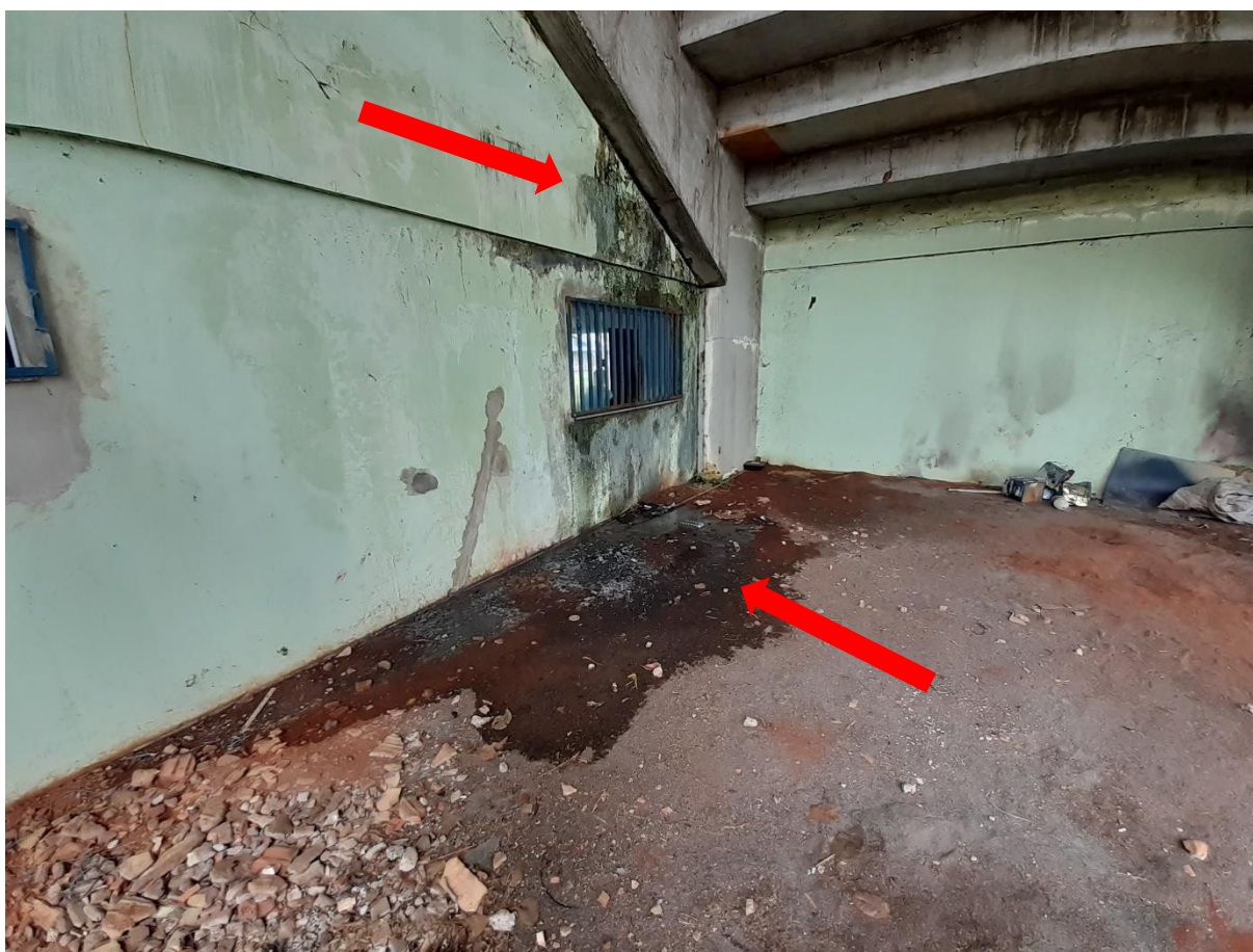
Foto 140: Esgoto – pia da cozinha
