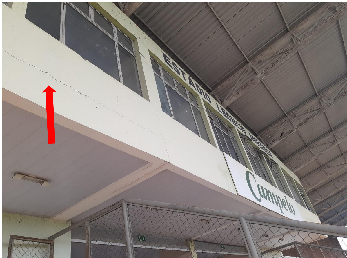
Foto 015: Vista da cabine
