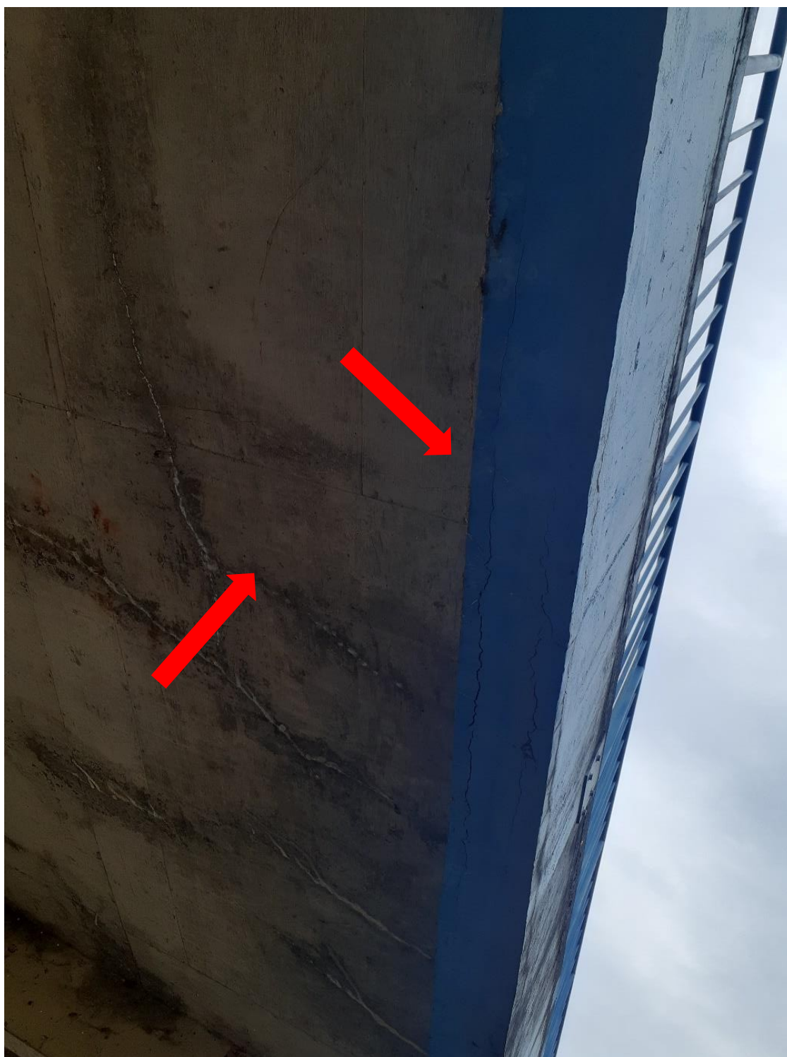
Foto 167: Infiltração em marquise
