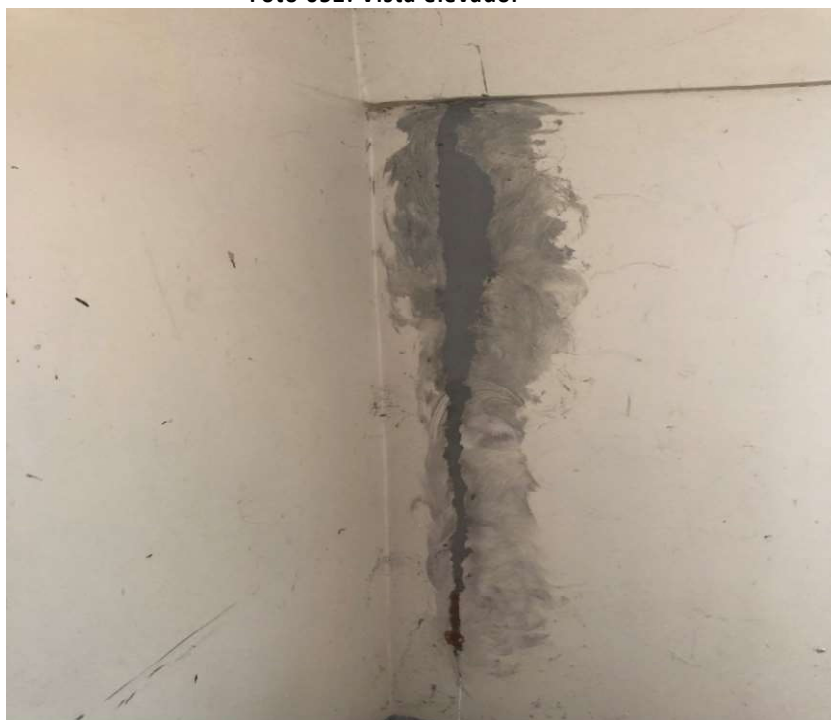
Foto 053: Vista parede com reboco exposto
