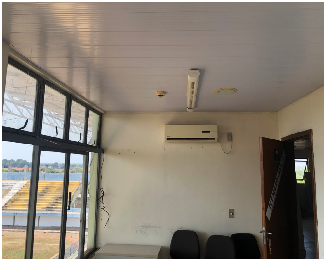
Foto 038: Vista geral da cabine TV e Rede Sat
