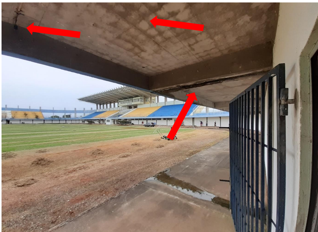
Foto 138: Infiltração em marquise
