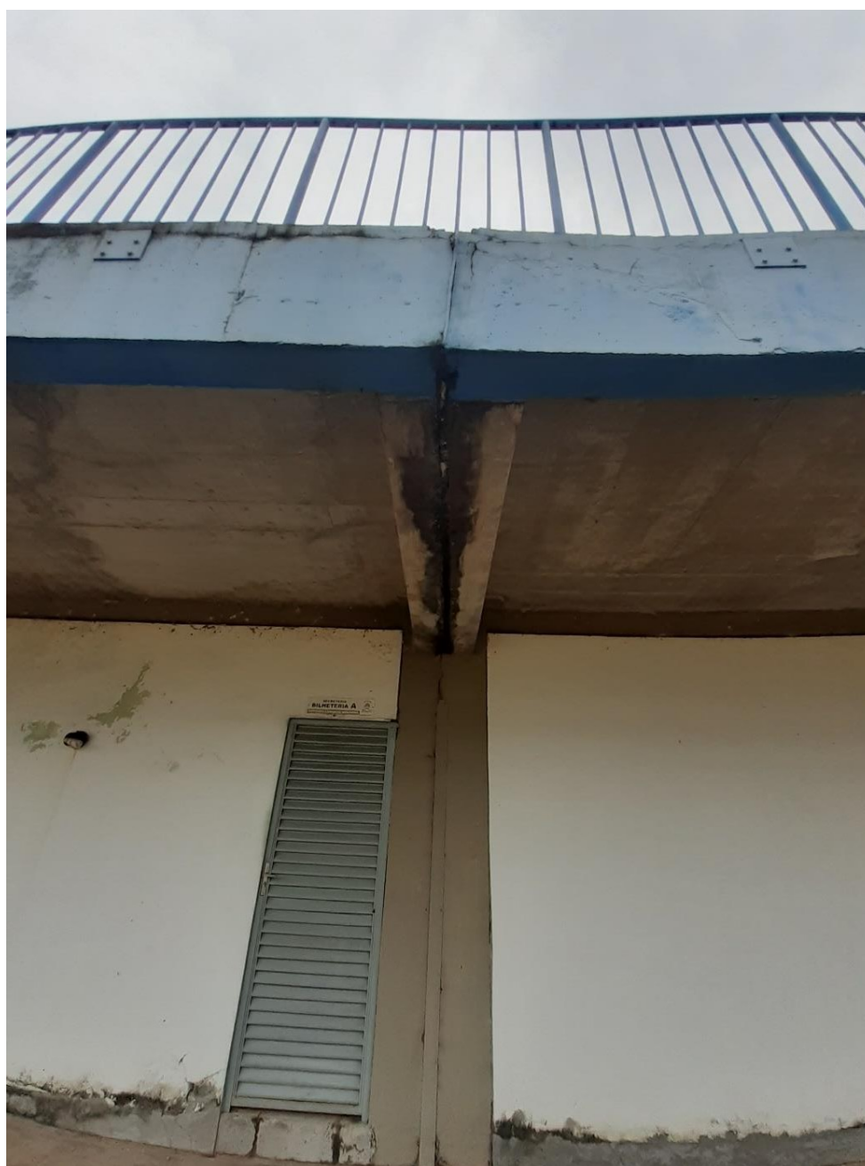
Foto 165: Infiltração em marquise
