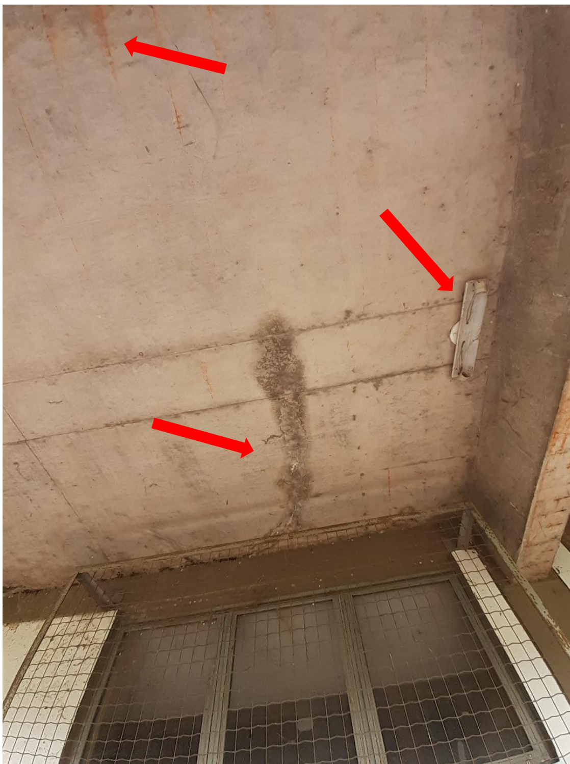
Foto 143: Infiltração em marquise
