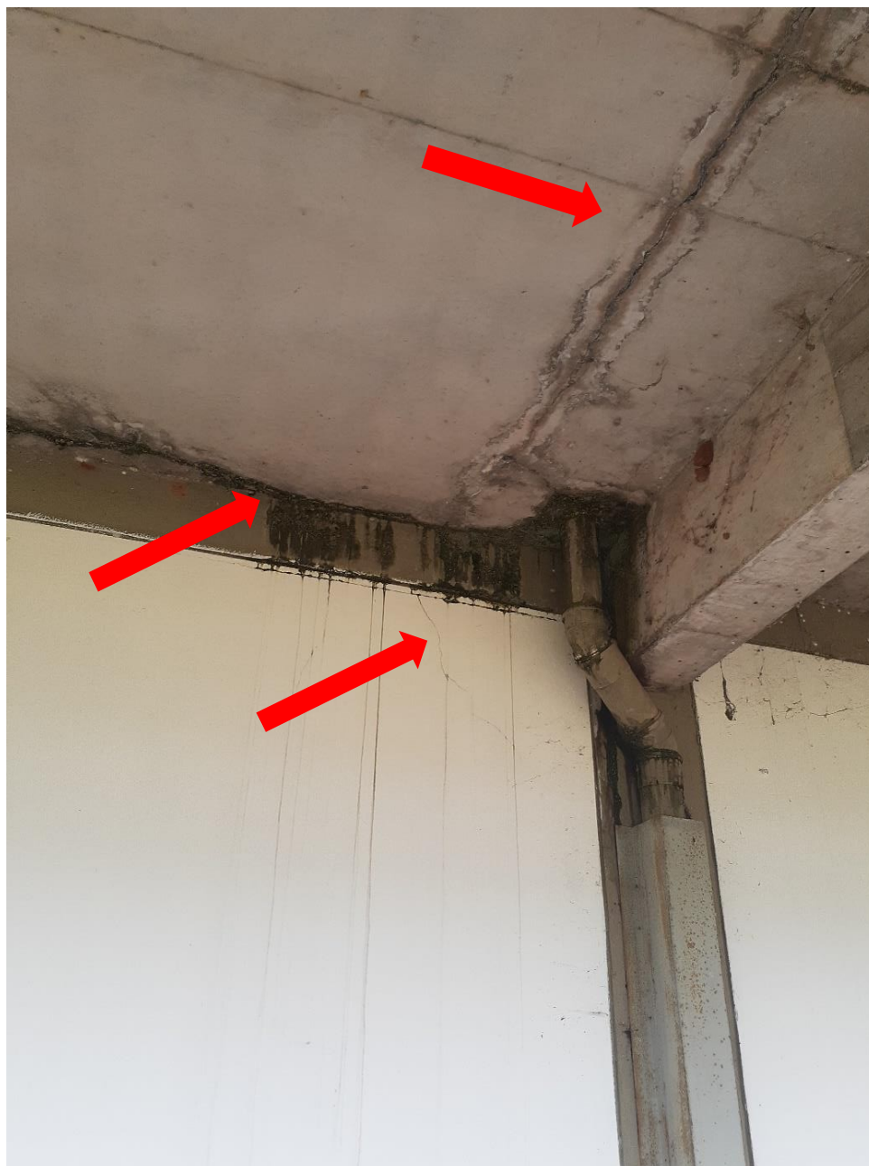
Foto 171: Infiltração em marquise
