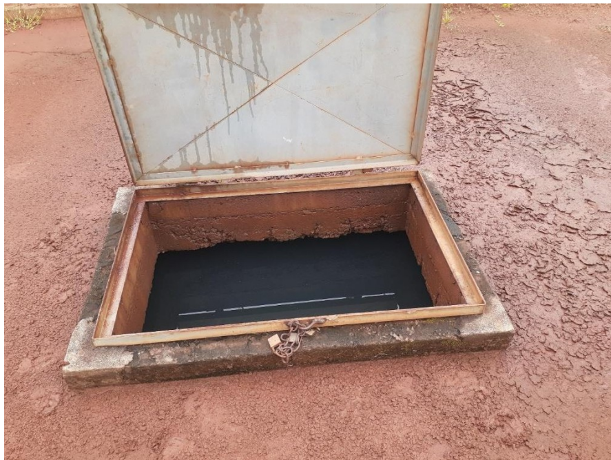
Foto 121: Reservatório que atende a irrigação e RTI
