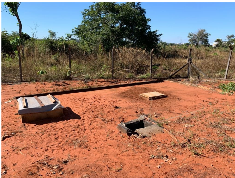
Foto 120: Vista do reservatório RTI - irrigação
