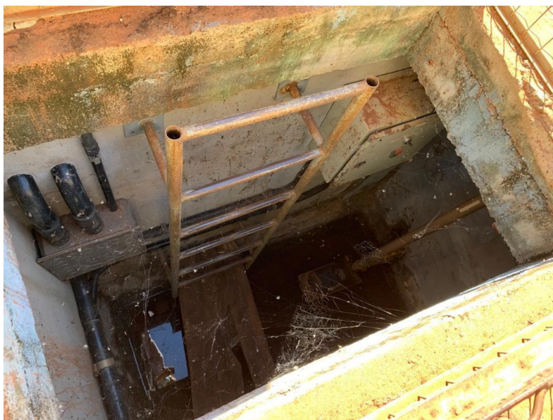
Foto 122: Casa de Máquinas - Reservatório de consumo
