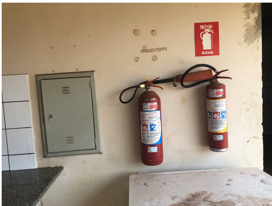
Foto 076: Vista quadro geral e extintores
