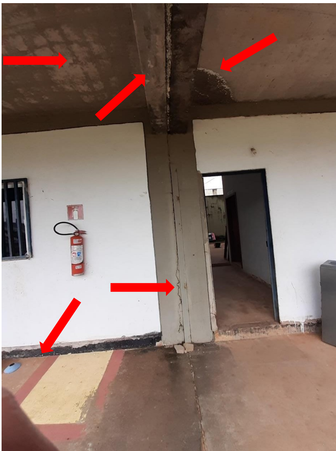
Foto 150: Infiltração em marquise
