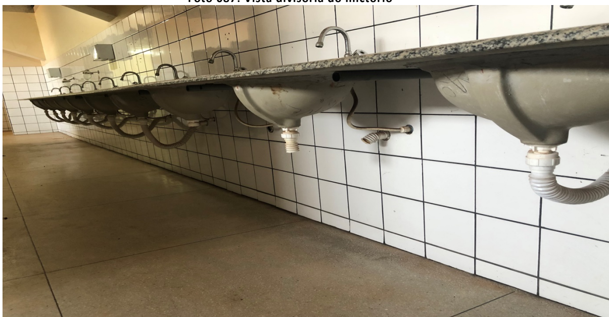
Foto 088: Vista instalações hidráulicas
