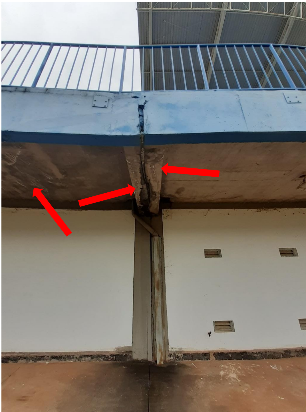
Foto 145: Infiltração em marquise
