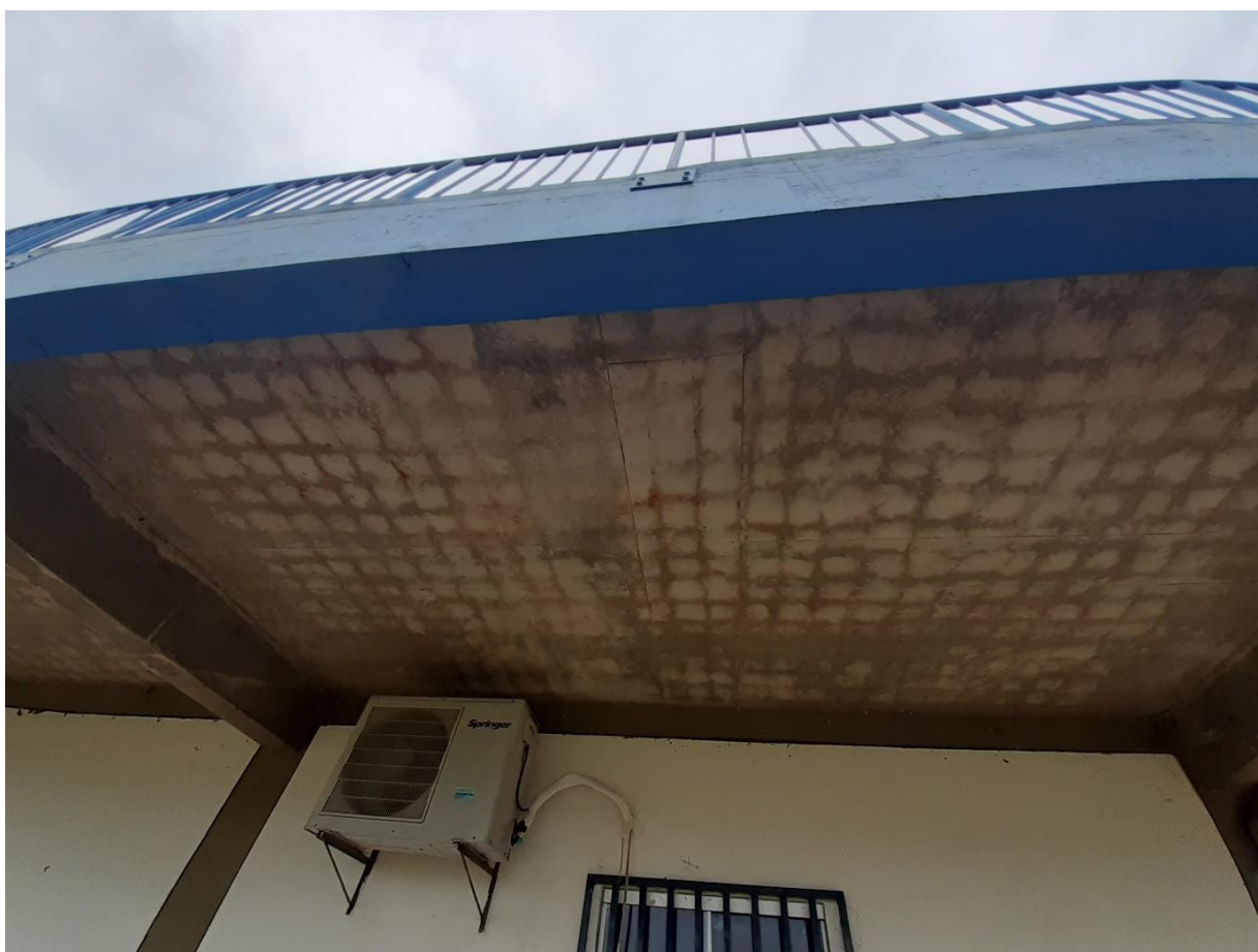
Foto 152: Infiltração em marquise
