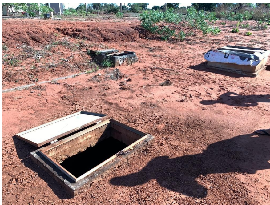
Foto 119: Vista do reservatório RTI - irrigação
