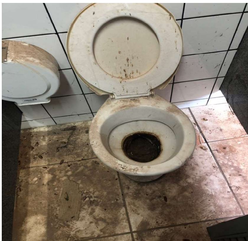
Foto 069: Vista vasos sanitários
