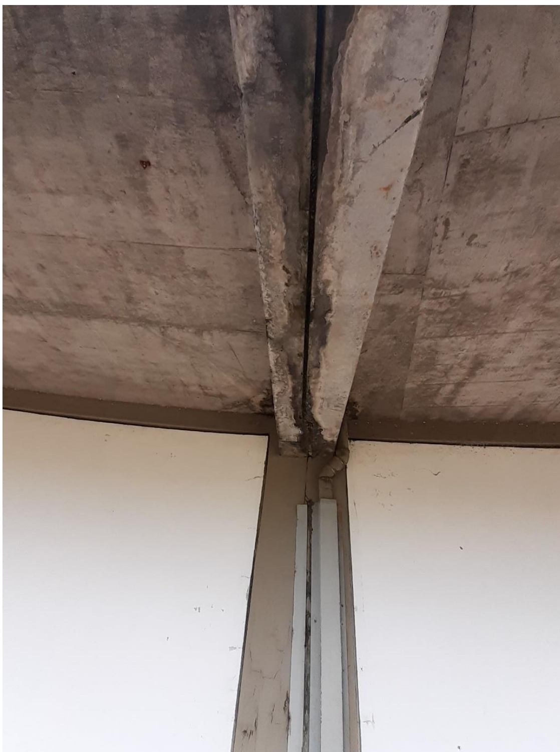
Foto 163: Infiltração em marquise
