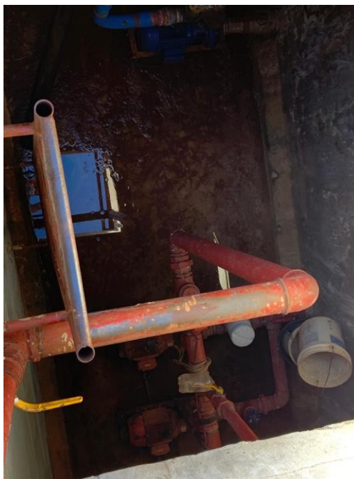
Fotos 123: Casa de Máquinas - RTI
