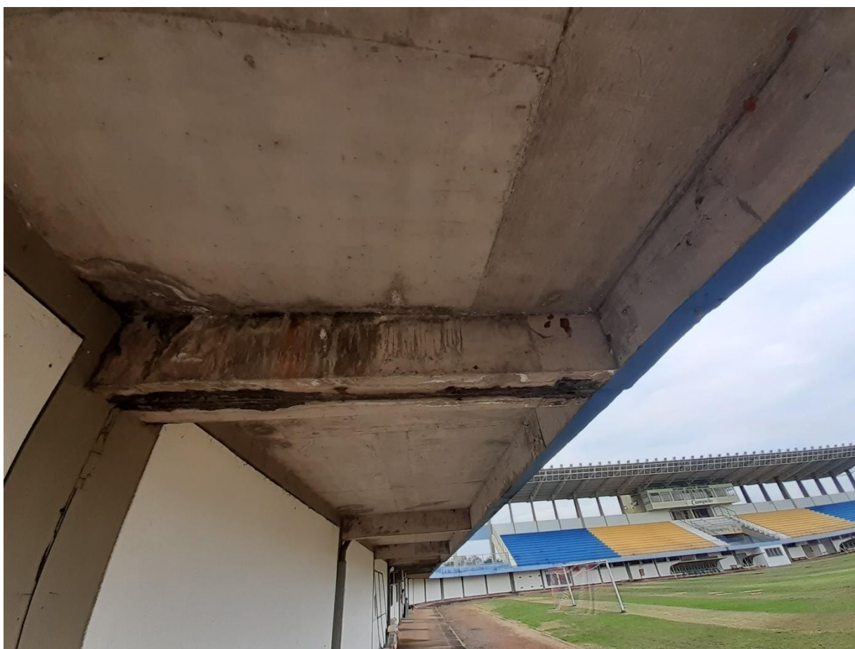
Foto 162: Infiltração em marquise
