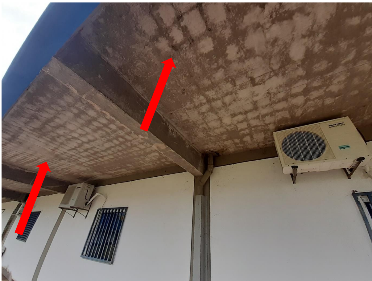
Foto 151: Infiltração em marquise
