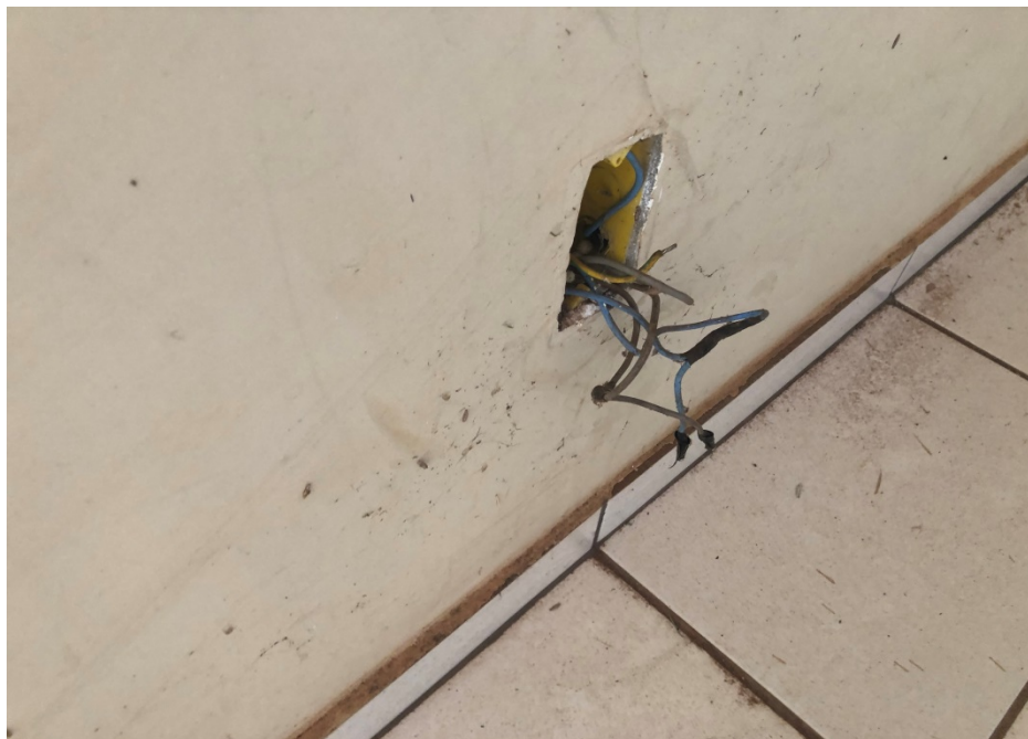
Foto 100: Vista componente elétrico da galeria
