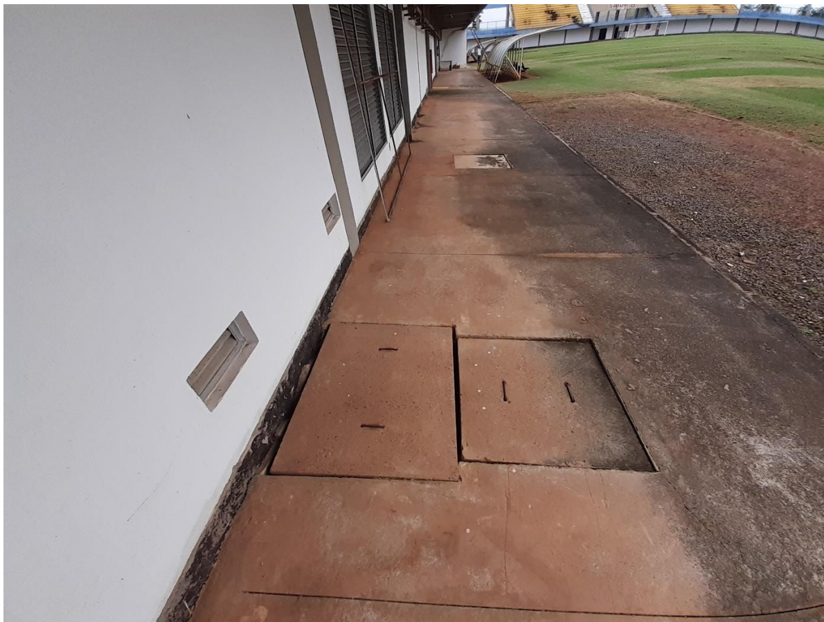
Fotos 144: Caixas de passagem
