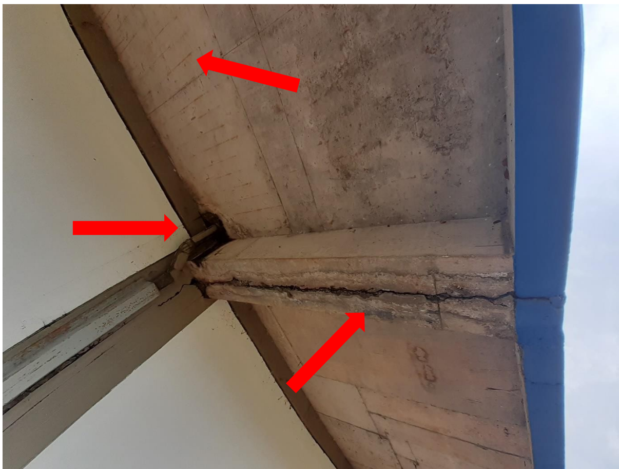
Foto 148: Infiltração em marquise
