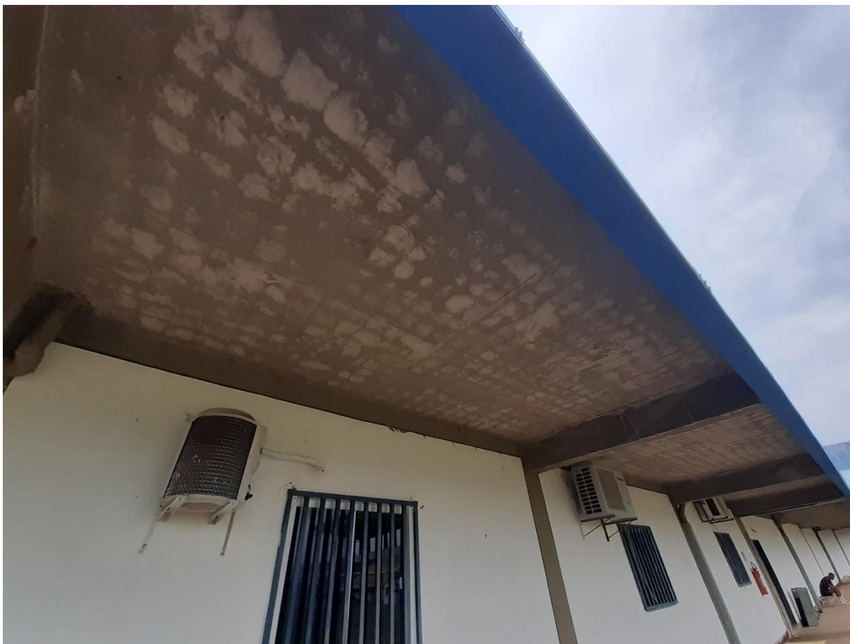
Foto 153: Infiltração em marquise
