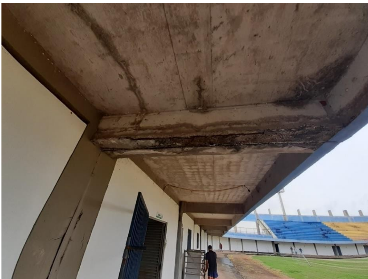
Foto 137: Infiltração em marquise
