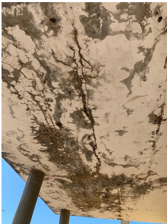
Foto 185: Face inferior da laje
