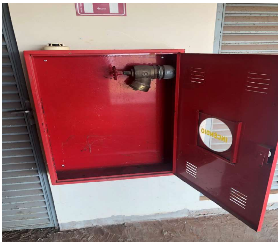
Foto 055: Vista do equipamento de combate a incêndio
