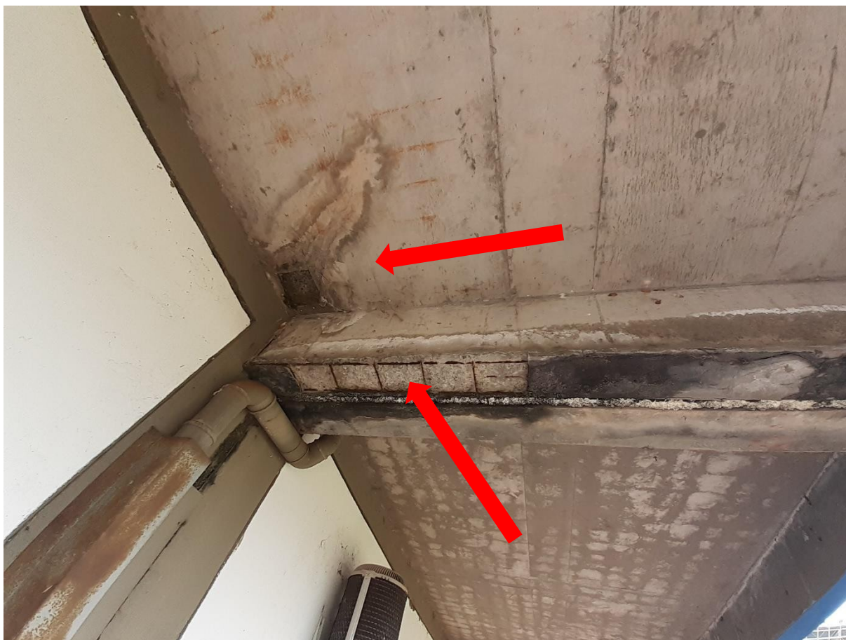
Foto 158: Infiltração em marquise
