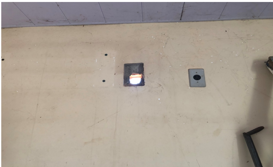
Foto 207: Vista buraco na parede
