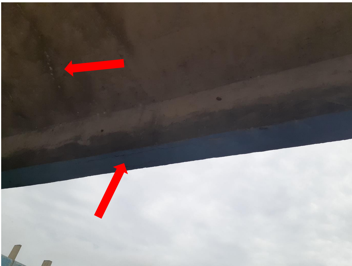
Foto 166: Infiltração em marquise
