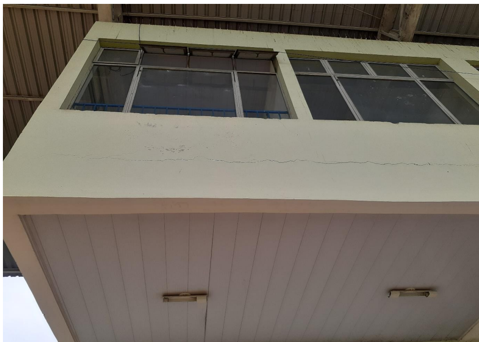
Foto 016: Vista parcial da cabine – lado esquerdo
