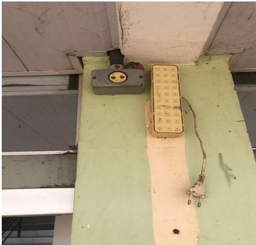
Foto 056: Vista lâmpada de emergência
