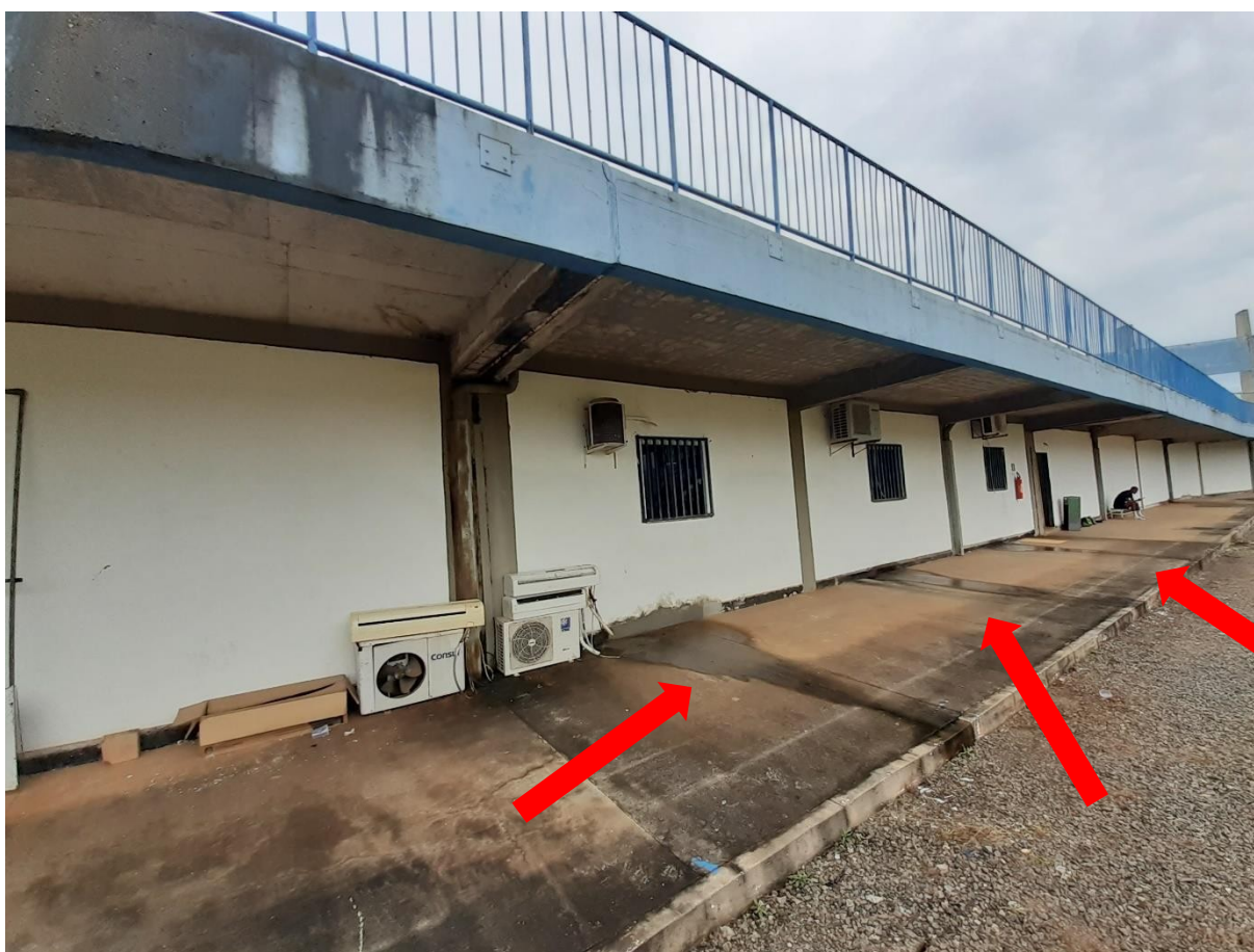
Foto 156: Infiltração em marquise
