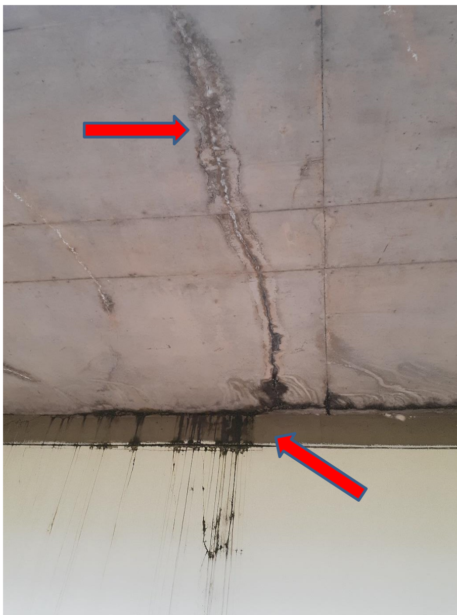
Foto 172: Infiltração em marquise
