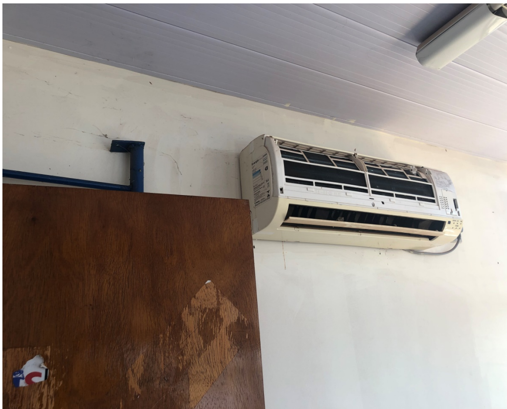
Foto 035: Vista ar condicionado da cabine 6
