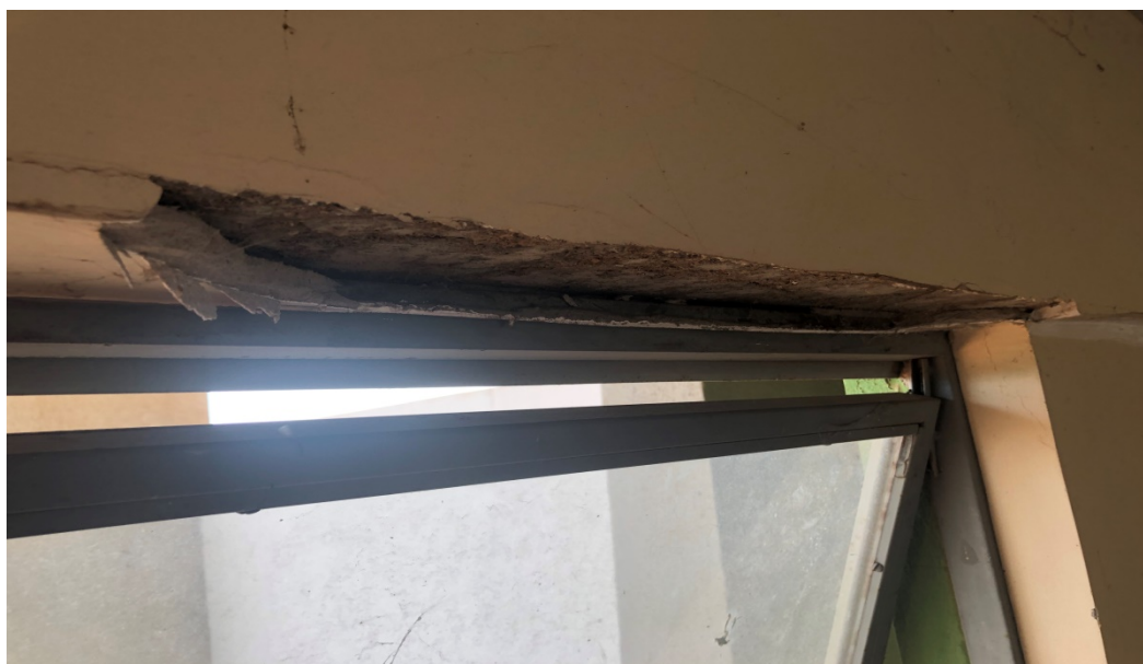
Foto 060: Vista patologia na janela
