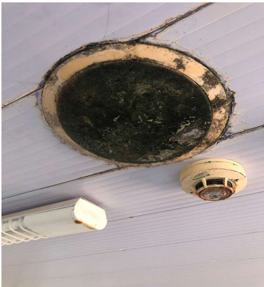
Foto 044: Vista saída de som e detector de fumaça
