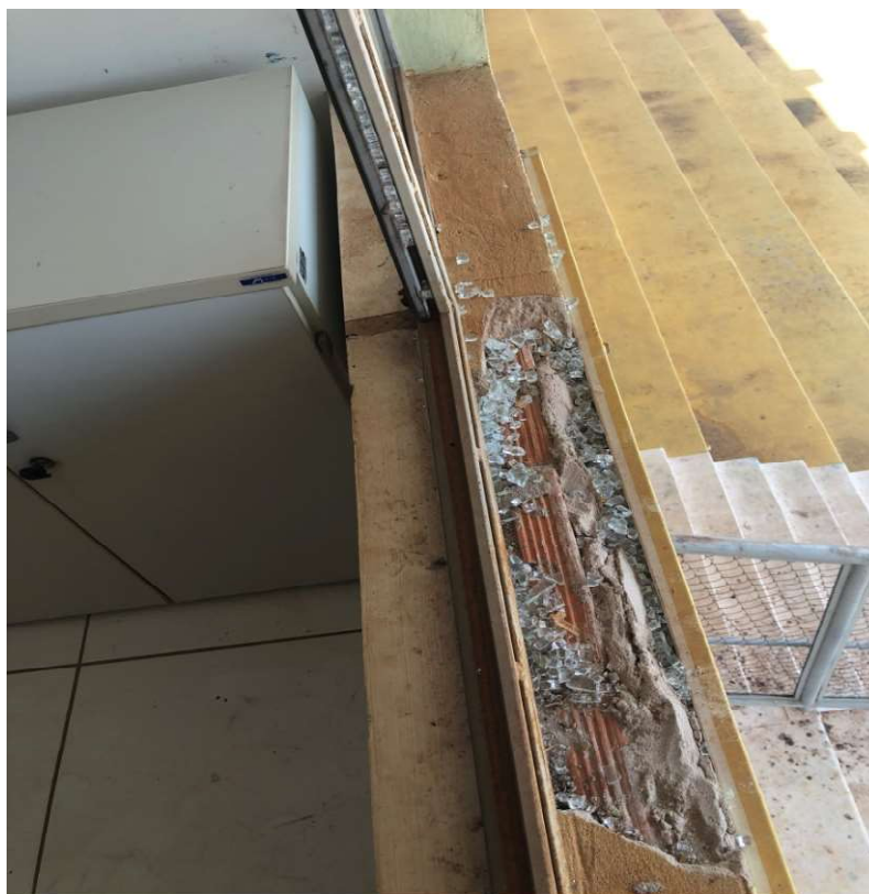
Foto 024: Vista peitoril da janela da cabine 3
