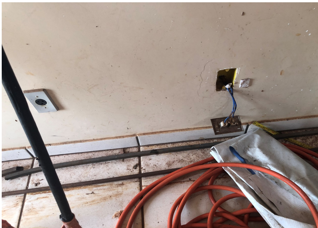
Foto 208: Vista componente elétrico
