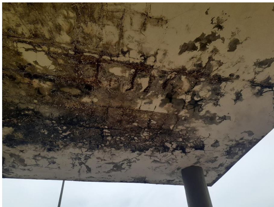
Foto 186: Face inferior da laje
