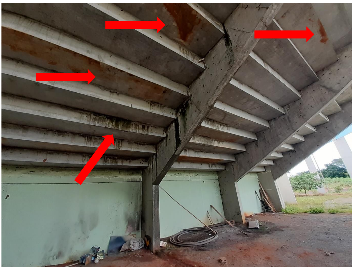
Foto 141: Infiltração através das arquibancadas
