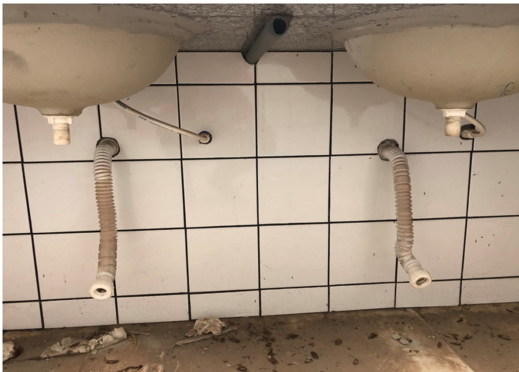
Foto 068: Vista instalações hidráulicas
