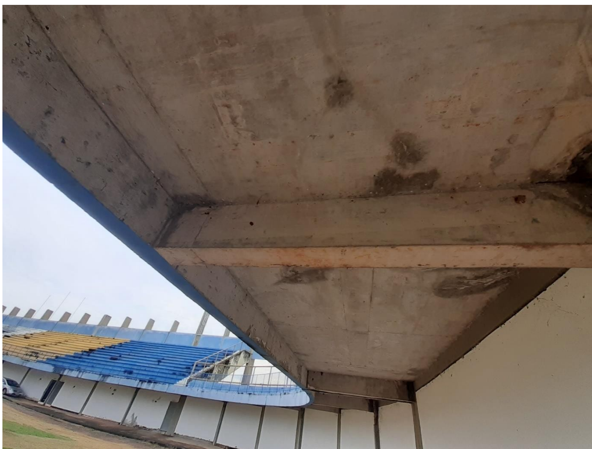
Foto 161: Infiltração em marquise
