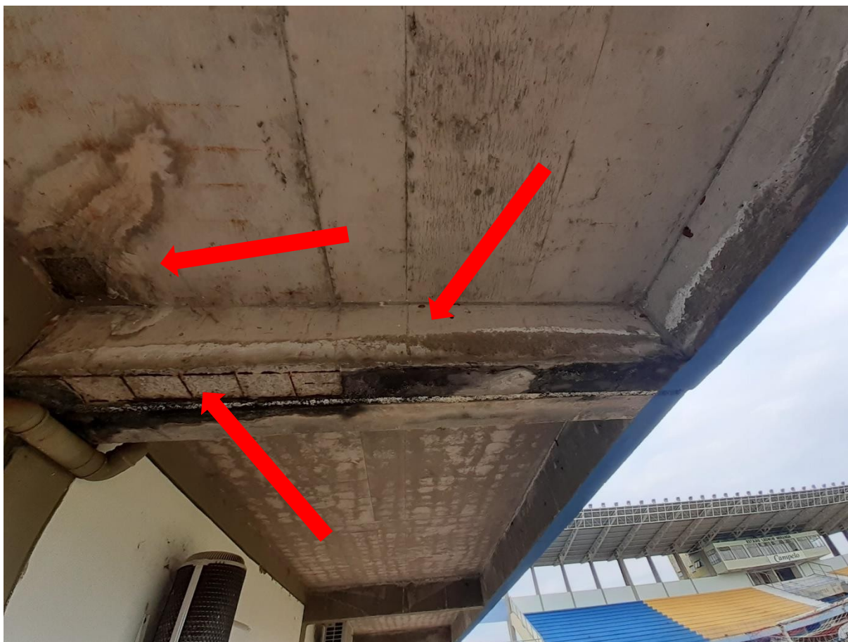
Foto 157: Infiltração em marquise
