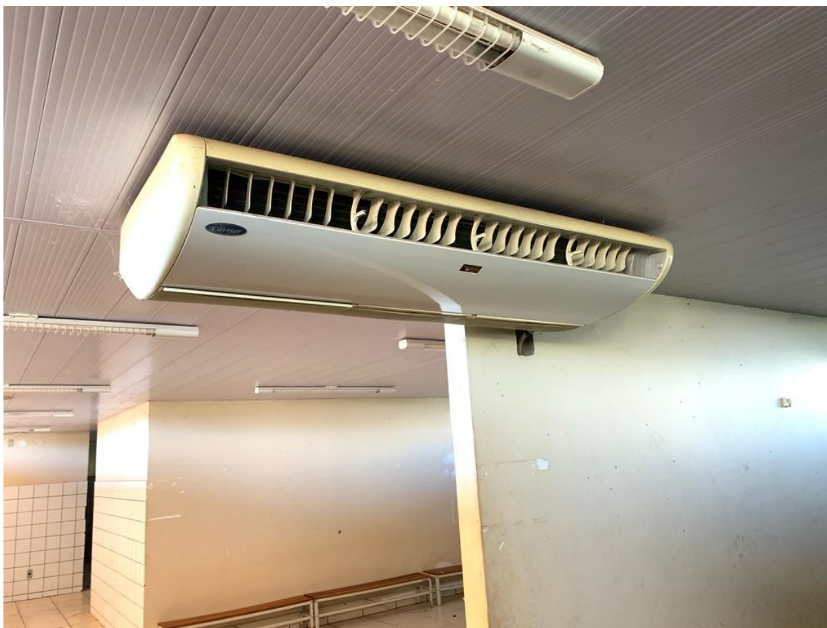
Foto 201: Condicionadores de ar
