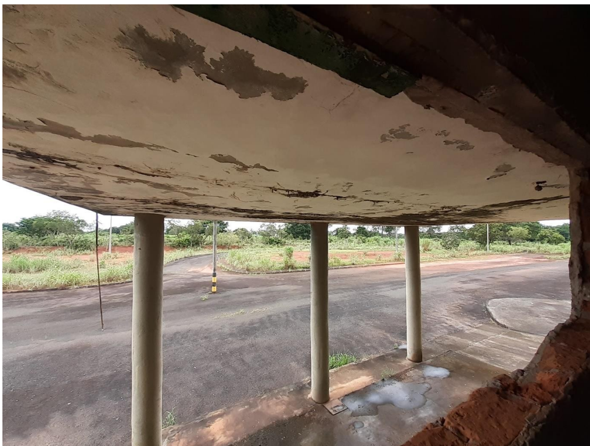
Foto 187: Face inferior da laje
