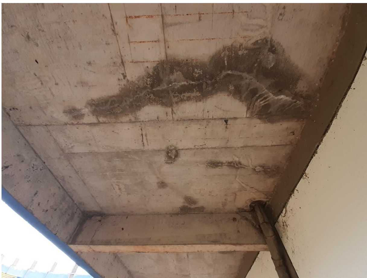
Foto 160: Infiltração em marquise
