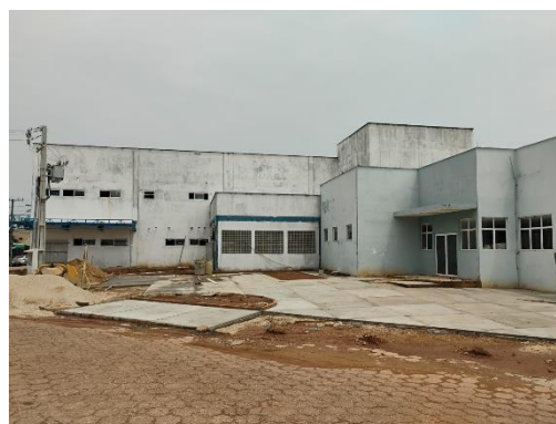
Imagem 02: Execução da Obra de construção do bloco da Maternidade no Hospital Regional de Augustinópolis.
