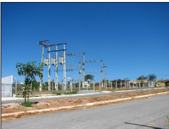
FOTO 4.4.1.23 - Sub-estação de energia em Arraias.
