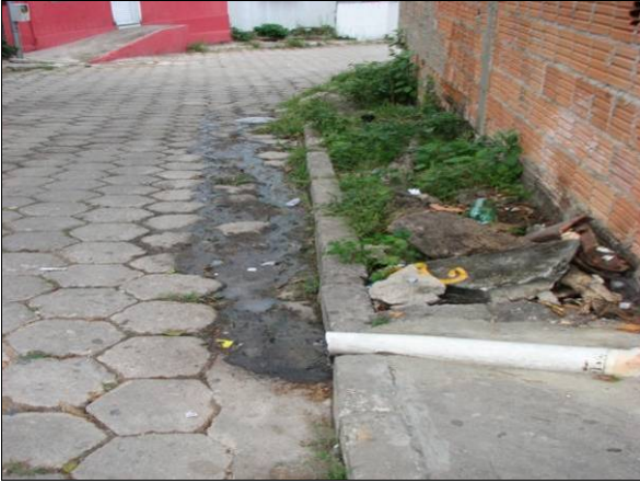
FOTO 4.4.1.7 - Esgoto doméstico lançado sem tratamento na rua na zona urbana de Arraias.
