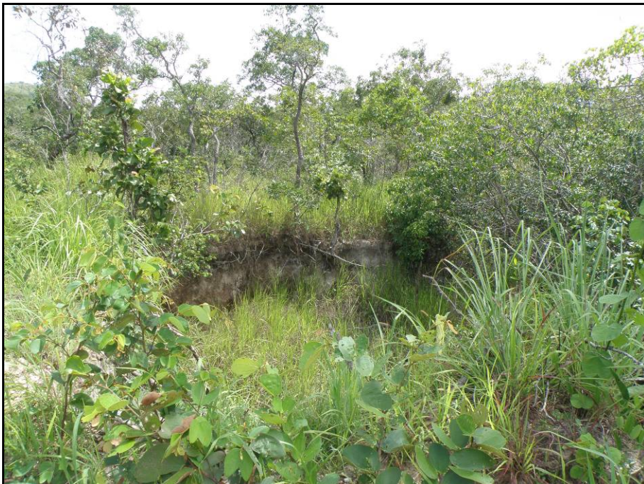
FOTO 4.2.4.40 – Pequena feição erosiva a beira de estrada de acesso na área de estudo.
